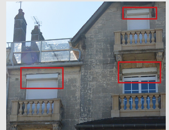
La pose de coffrages de volets roulants extérieurs sur le domaine public est interdite.
